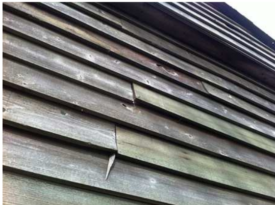
Open kieren aan de onderzijde van de houten betimmering van de zuidgevel.
