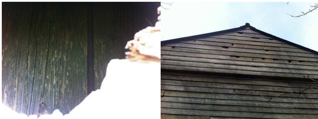
Gaten in de gevelbetimmering.
