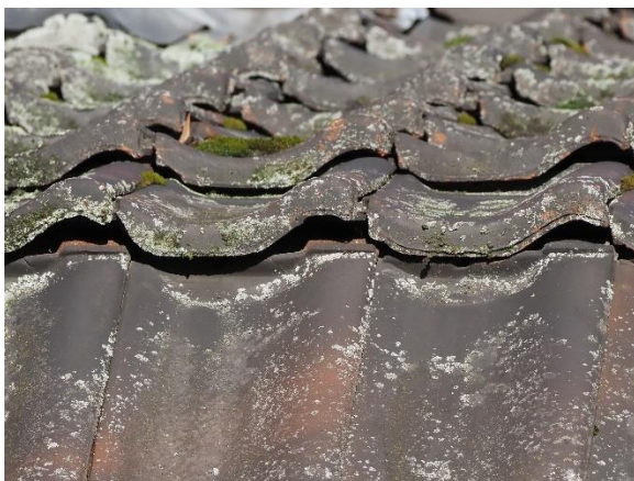
Figuur 19: scheefliggende dakpannen woonhuis
