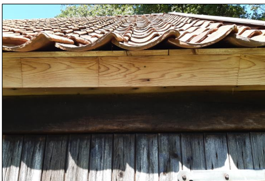
Tussen de platte pannen en het dakbeschot zijn geschikte plekken aanwezig voor gebouwbewonende vleermuizen.
