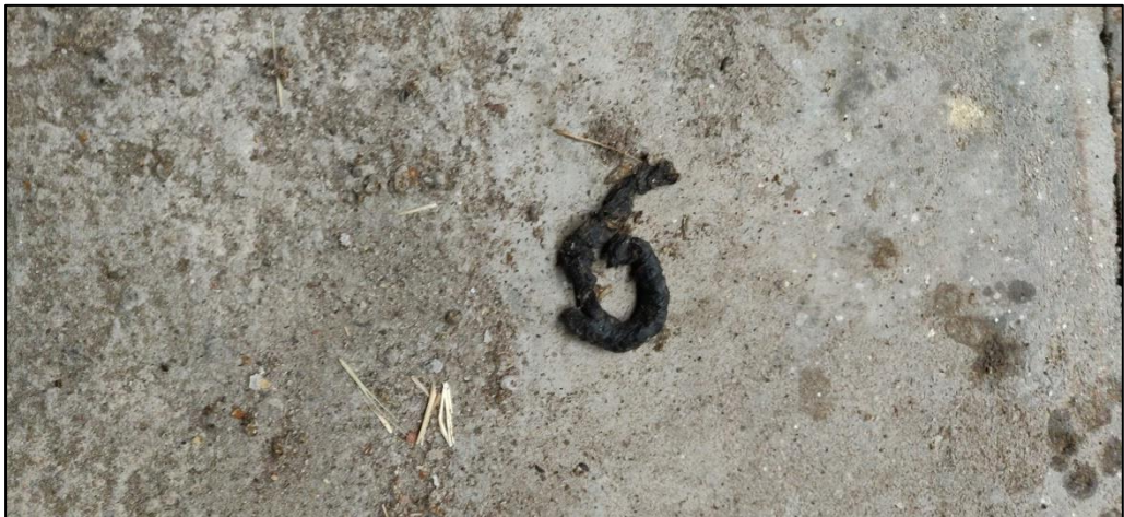
Eén van de enkele steenmarteruitwerpselen in de oostelijke helft van de schuur
