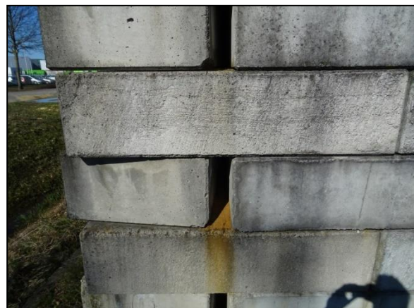
Figuur 10. Holtes in de muur die zich om de noordzijde van de onderzoekslocatie bevindt.
