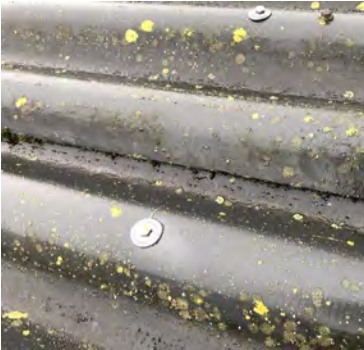
Asbestrij dak op schuur buiten onderzoeksgebied
