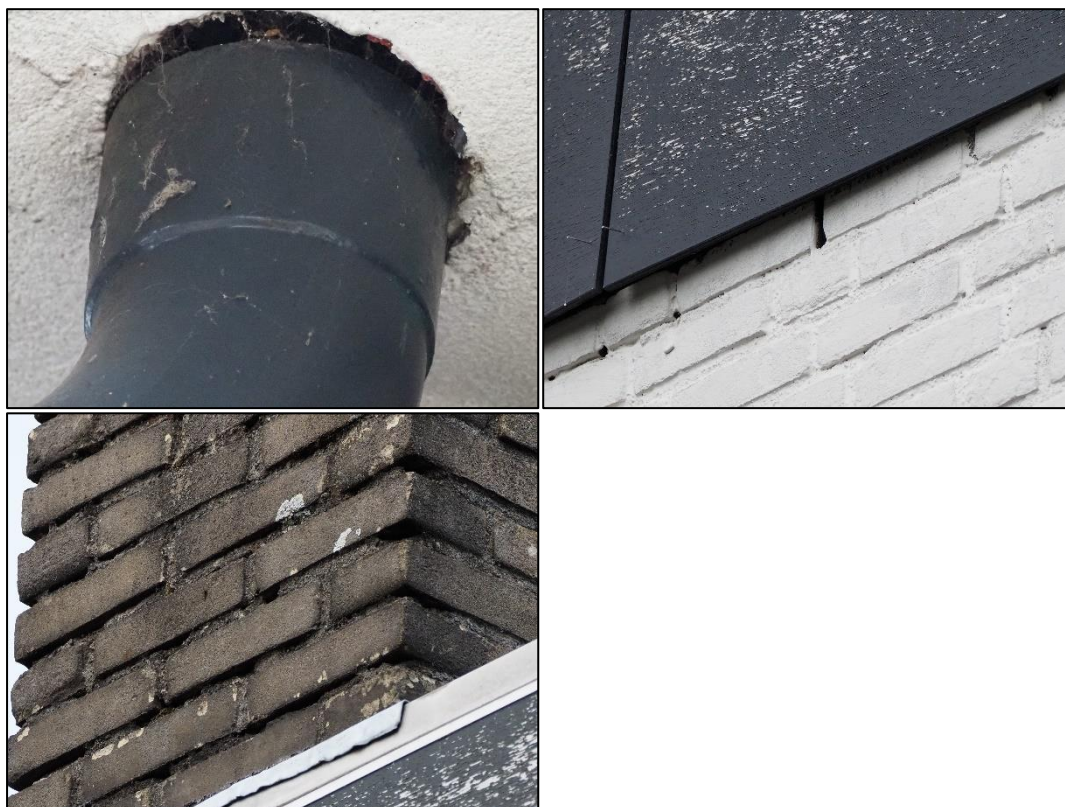
Figuur 6.12 (links boven): Regenpijp met ruimte er omheen met daartussen de spinnenwebben; Figuur 6.13 (rechts boven): boeiboord met daaronder een gat; Figuur 6.14 (links onder): een gedeelte van de schoorsteen met kieren en gaten.
