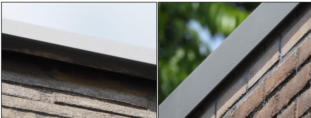
Figuur 6.7 (links): Opening tussen muur en ijzeren daklijst aan voorkant rode gedeelte; Figuur 6.8 (rechts): Opening tussen muur en ijzeren daklijst aan zijkant rode gedeelte.
