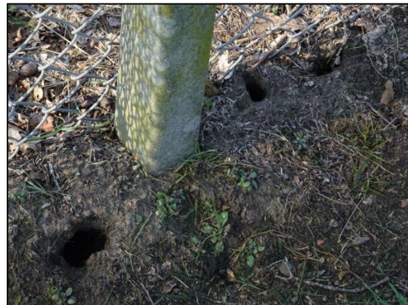
Figuur 13. Muizenholten ter hoogte van het hekwerk.
