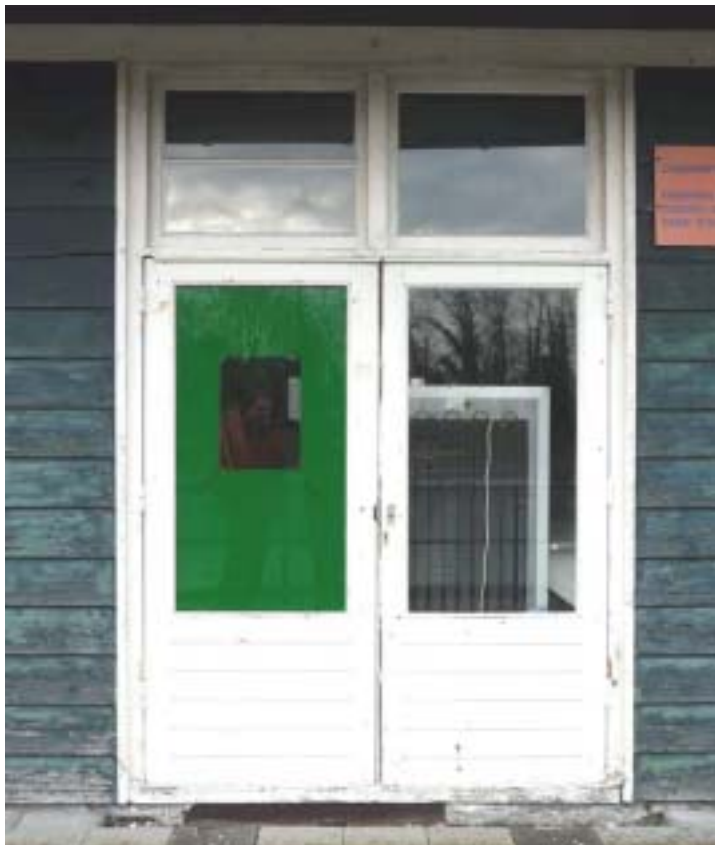
Afb.25 Eén van de deurpartijen ter plaatse van het balkon.
